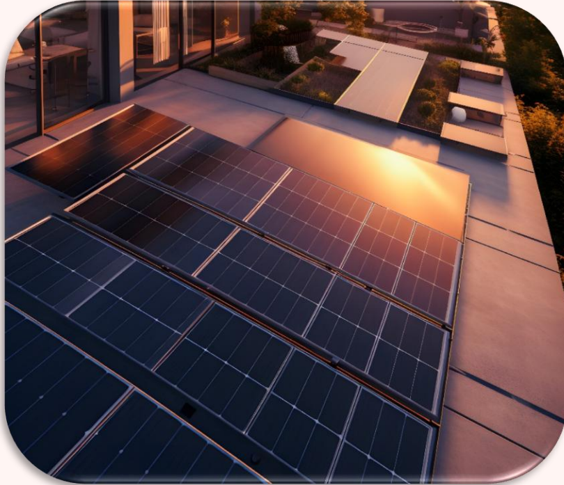
PANNEAUX PHOTOVOLTAÏQUES Dans les Espaces Communs
